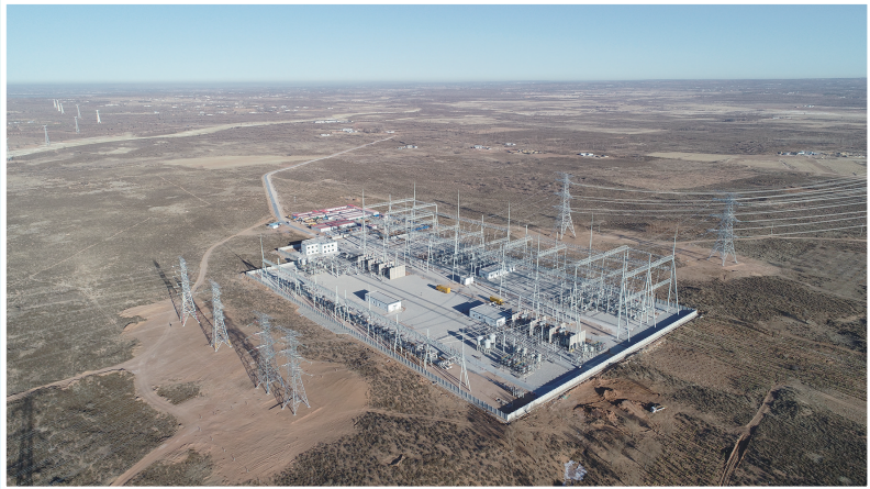
2019年1月9日，集团公司首座HGIS变电站——甘迪尔500千伏变电站投入运行。该站的投运，将全面破解鄂尔多斯南部电网风险，有效提升该地区的供电能力、网架结构大幅改善。
