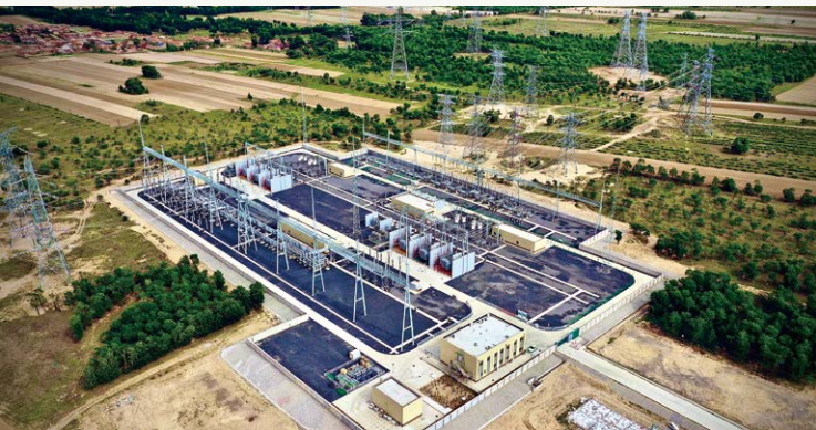
▲ 巨宝庄 500 千伏变电站
